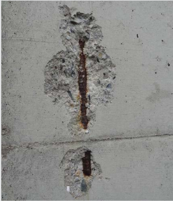
写真1 コンクリートの中性化による鉄筋腐食とはく離
