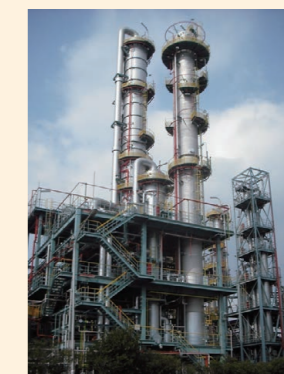
大分工場アクリル酸製造設備
