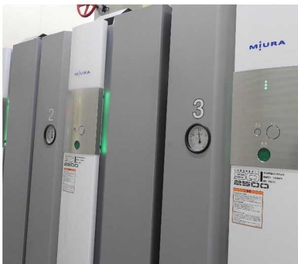
ボイラーの燃料転換
