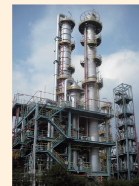
大分工場アクリル酸製造設備
