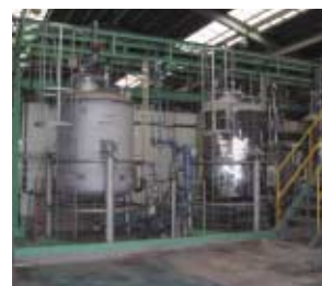
高純度苛性ソーダタンク
