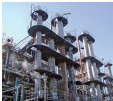
アクリル酸エステルのプラント
