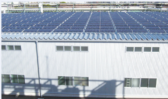
R&D総合センター 中間試験棟屋根の太陽光発電パネル
