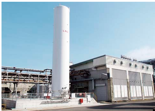
LNG設備 [徳島工場]
