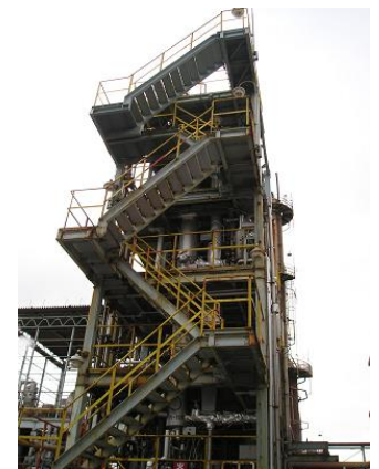
パイロット試験設備 （大分ケミカル）
