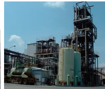
横浜工場 製造設備
