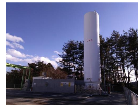
広野工場LNG設備
