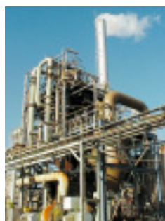
廃液燃焼設備(名古屋)
