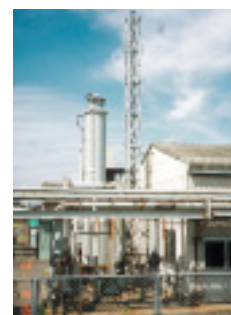
塩素除害塔(坂出)
