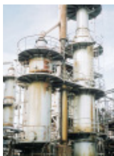
廃液燃焼設備(徳島)
