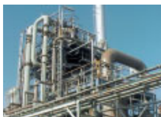
廃液燃焼設備
