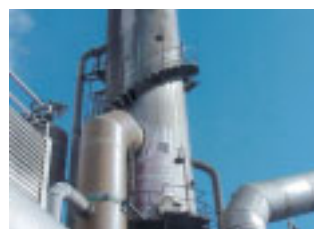
大気排出除害設備
