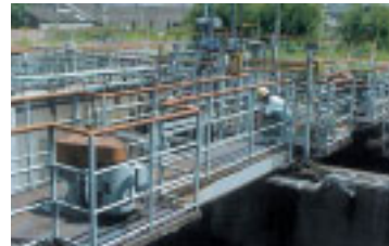
排水処理設備(名古屋)
