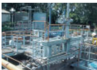
排水処理設備
