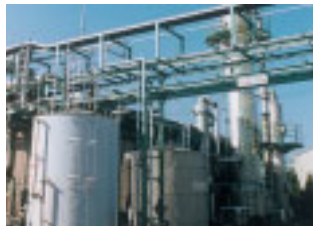
排煙脱硫設備
