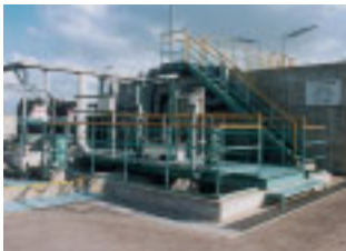
排水処理設備
