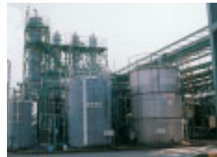
塩素除害設備
