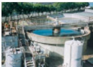
排水処理設備
