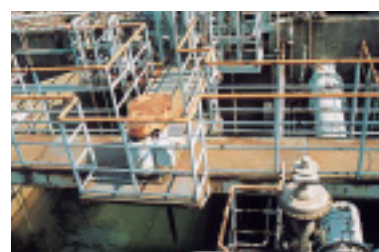
排水処理設備 (名古屋)
