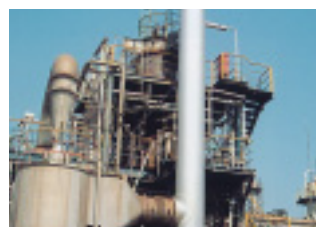
廃液燃焼設備
