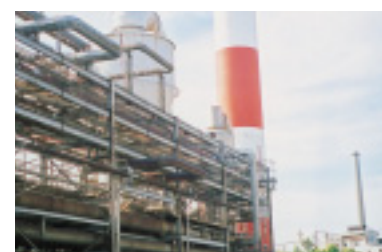
ボイラー脱硫塔 (徳島)
