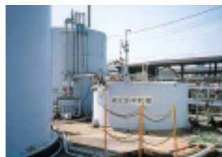
排水処理設備
