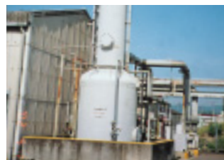
塩素除害設備
