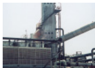
大気排出除害設備
