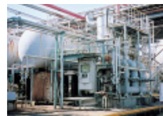
大気排出除害設備
