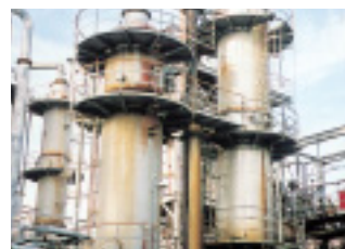
廃液燃焼設備
