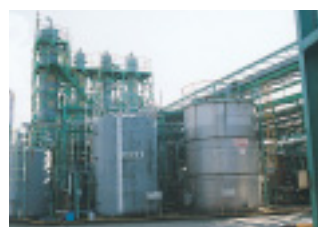
塩素除害設備
