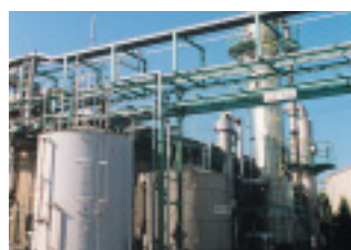
排煙脱硫設備
