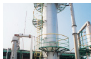
ボイラー脱硫設備 (高岡)
