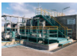
排水処理設備
