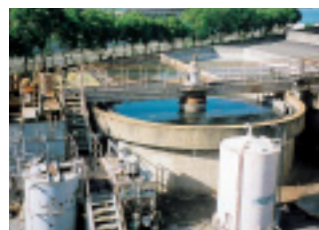
排水処理設備
