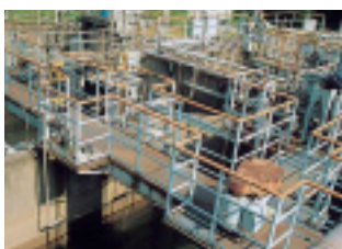
排水処理設備
