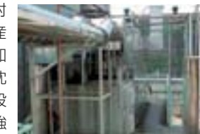
触媒酸化脱臭装置
