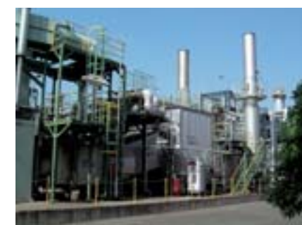
自家発電設備(名古屋工場)
