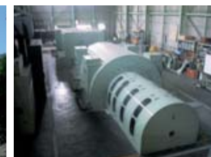
自家発電装置(徳島工場)
