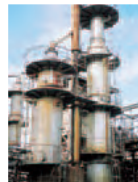
廃液・廃ガス燃焼設備(徳島工場)
