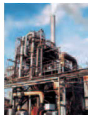
廃液・廃ガス設備(名古屋工場)
