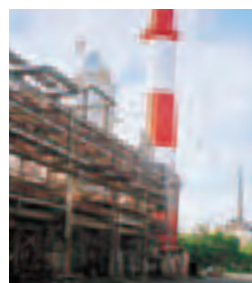
ボイラー脱硫塔(徳島工場)
