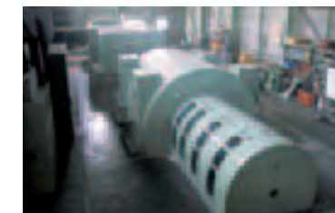
徳島工場自家発電装置
