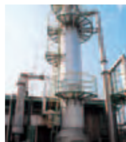
ボイラー脱硫設備(高岡工場)
