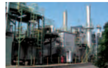
名古屋工場自家発電設備
