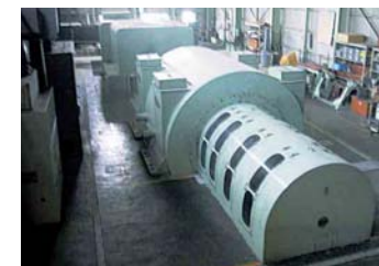
徳島工場自家発電装置
