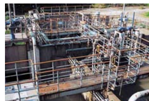
排水設備 (名古屋工場)
