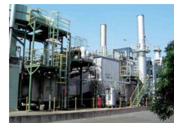
名古屋工場自家発電設備
