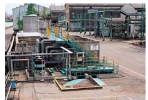
排水設備 (高岡工場)
