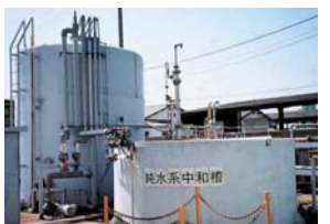
排水設備 (坂出工場)
