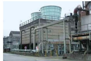
循環水冷却塔 (名古屋工場)
