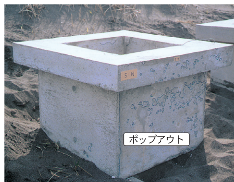
非塗装供試体 ポップアウトが発生している
