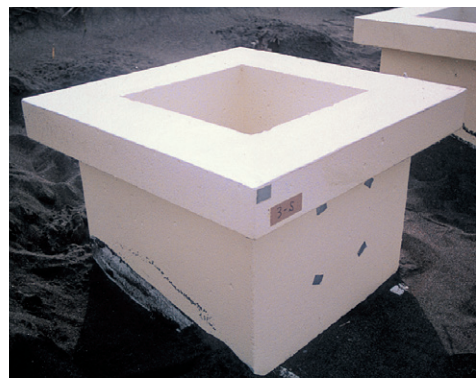
アロンブルコート塗装 異常は認められない
