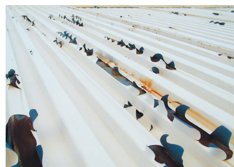
従来の防錆塗料の劣化
