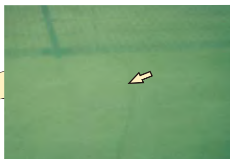
下地コンクリートにひび割れが発生しているがSQ塗膜に破断は認められない。
