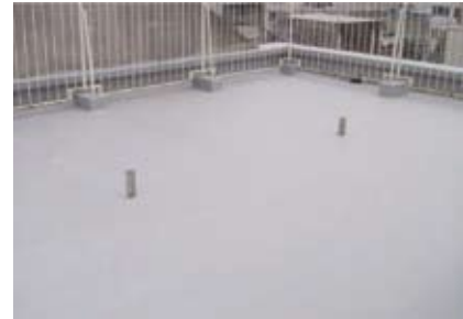
脱気筒の設置例
