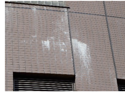
▲タイル割れ部からのエフロレッセンス（白華現象）の流出
