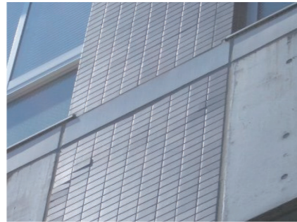
▲タイルの浮き、はく離
