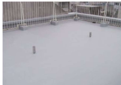
脱気筒の設置例
