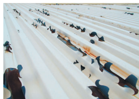
従来の防錆塗料の劣化
