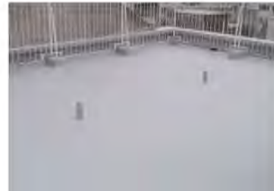
脱気筒の設置例
